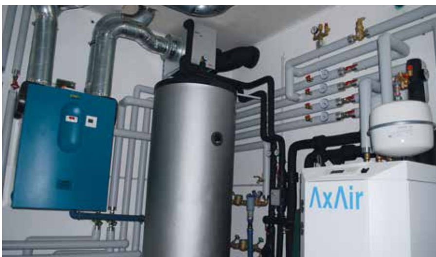
Abb. 24 | Die Energiezentrale mit Wärmepumpe, Warmwasserspeicher, Umwälzpumpe und Verteilerleitungen etc. ist übersichtlich auf kleinstem Raum zusammengestellt.
