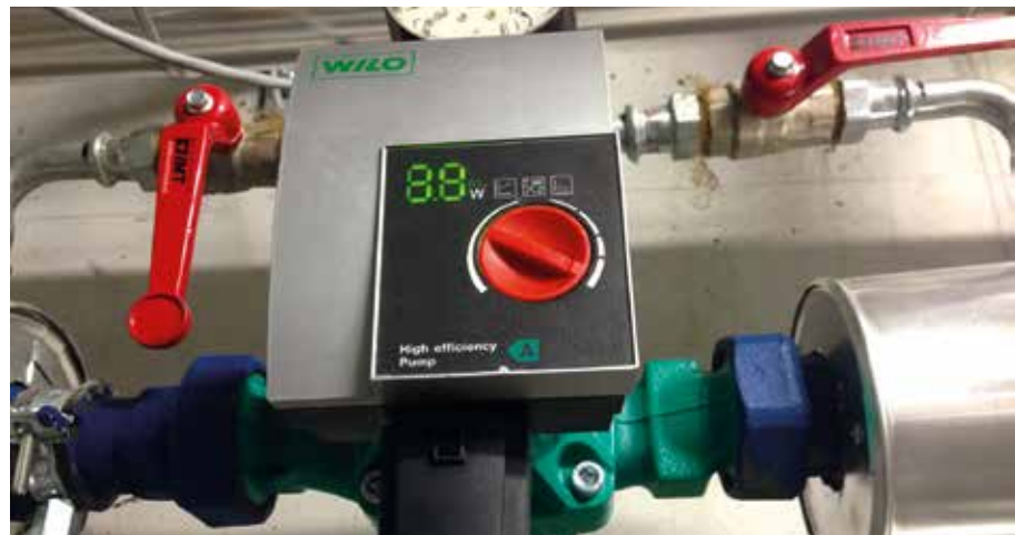
Abb. 27 | Rohrdurchmesser und Rohrlänge und damit der Strömungswiderstand sind Kriterien zur Dimensionierung der Umwälzpumpe. © FIN – Future Is Now, Kuster Energielösungen GmbH
